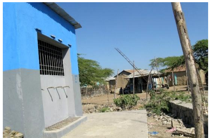
Borne fontaine rénovée par Oxfam Québec, mais non raccordée au réseau d'eau
